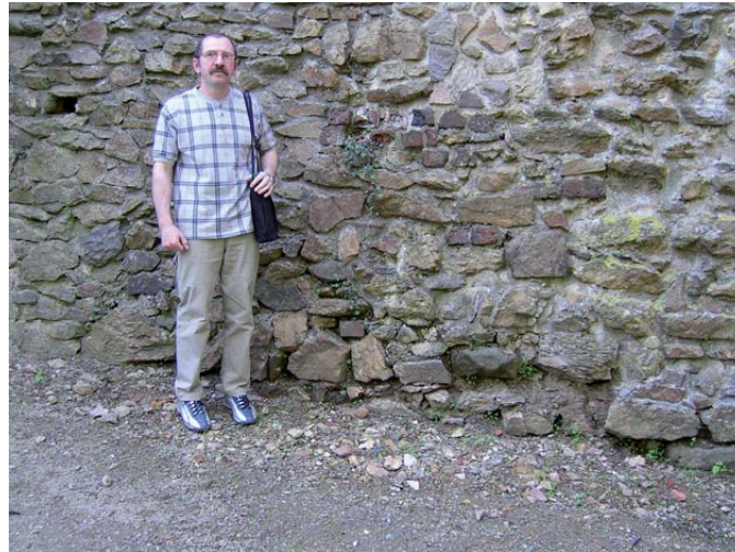
Abb. 4.13: Verwitterungs- und Denudationsspuren an alten Steinmauern in Dresden (es ist deutlich zu sehen, dass die Mauern besonders stark ganz unten davon betroffen wurden)
